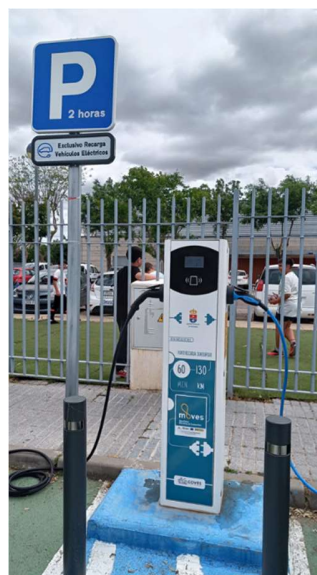
2. PUNTO DE RECARGA EN LA PISCINA CUBIERTA
